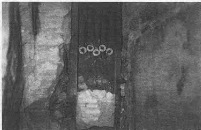
2. ábra. Az eredeti XIX. századi favályús porcelán csigás vezeték az 1998-as rekonstrukció idején feltárva (A MEEM által készített fénykép)
